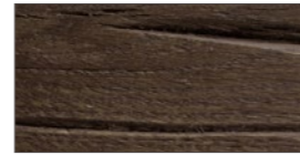
..... V - verwittert / lackiert
